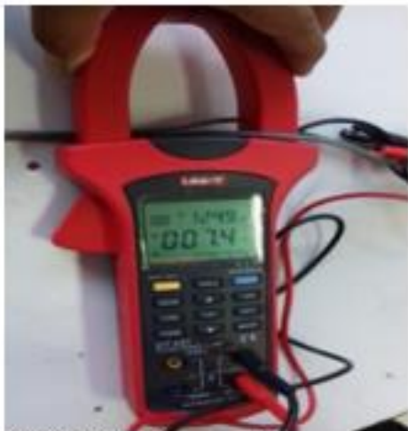
Figura 21 Medición de potencia en arranque directo.
